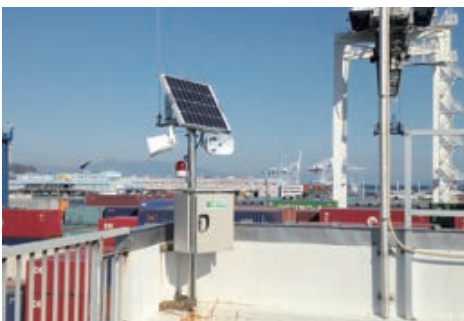
屋外作業場所のある 津波避難ビルの屋上へ設置 清水コンテナターミナル株式会社様 (静岡県静岡市清水区)
