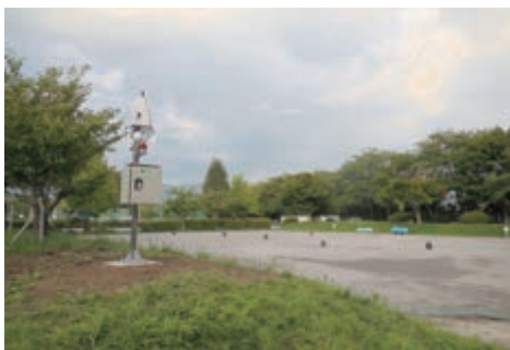
敷地内にある一般の方も利用する グラウンド、野球場等の付近へ設置 某下水道終末処理場様 (長野県)
